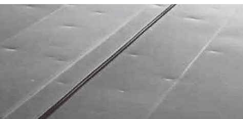
▲2008年6月11日 ひよう被害を受けた加入者宅の屋根の写真
